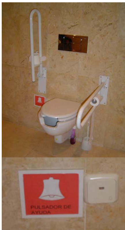
Inodoro con espacio transferencia por ambos lados y sistema de alarma en caso de caída.
